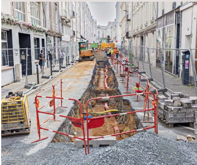
Le renouvellement des réseaux a démarré rue Parcheminerie. Les aménagements futurs prévoient notamment une piétonnisation du secteur le soir et le week-end.
