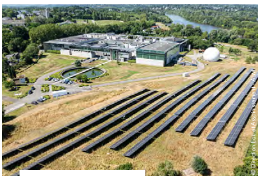
La centrale solaire au sol sur le site de la Baumette.
