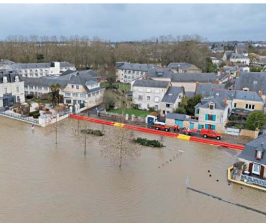
Barrage mobile au port des Noues, aux Ponts-de-Cé.
