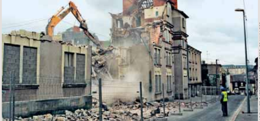
Démolition de l'immeuble collectif construit par le Cottage Angevin, rue Prosper-Bigeard, 1 er avril 1998.
