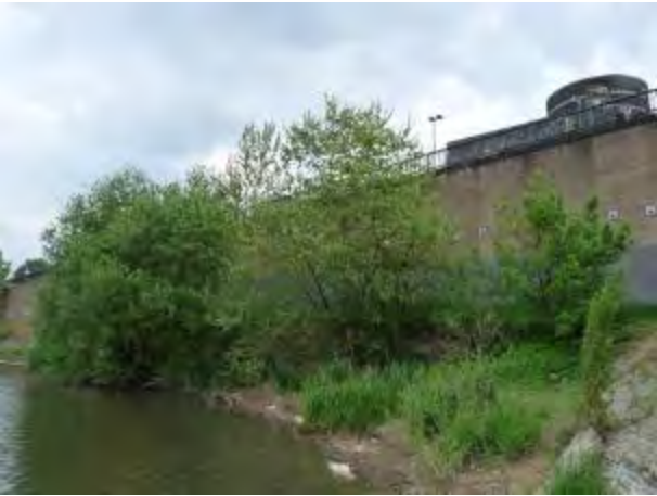
Saulaie blanche dégradée en amont du pont de la Basse Chaîne (29 avril 2021)
