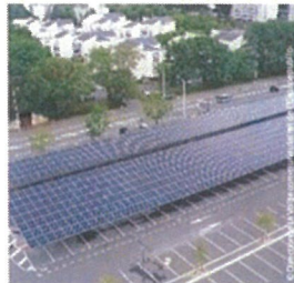
Ombrières Parking Relais la Barre à Belle-Belle - 2025
