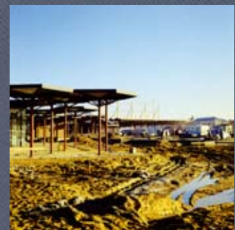
Chantier de construction de Super M au Chapeau-de-Gendarme. 1972. Photographie. Arch. mun. Angers
